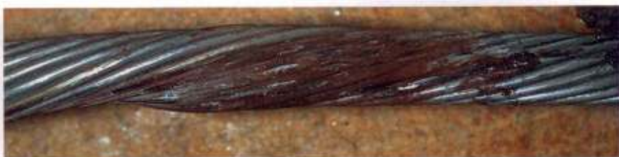
Bild 4: Verschleiss und Reibkorrosion an einer Knotenlitze nach ca. 50.000 Biegewechseln
